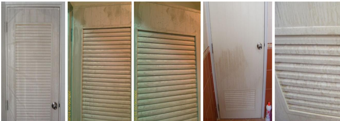
รูปที่ 4: ตัวอย่างการเกิดปัญหาคราบดำบนประตูห้องน้ำพีวีซี
