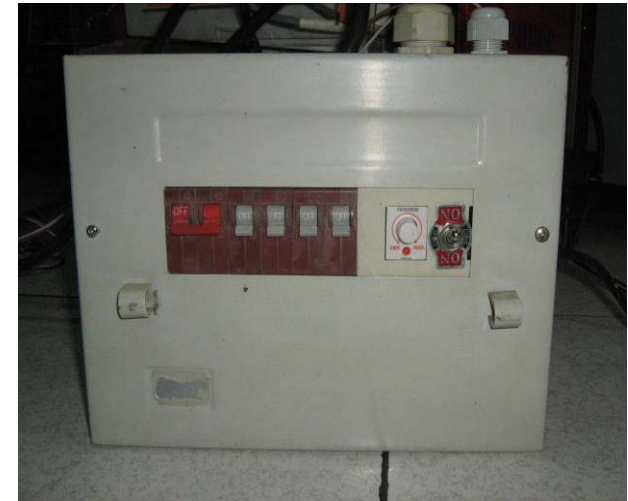
กล่องควบคุมมอเตอร์
